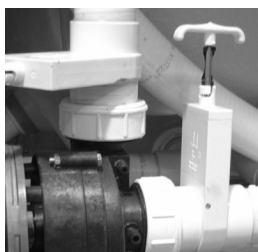
Vanne guillotine et Raccord de pompe
