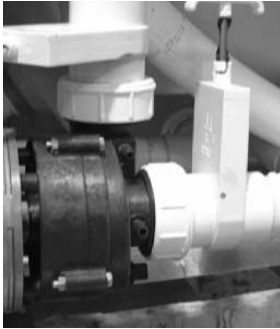
Sperrschieber und Pumpenverschraubung
