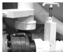
Raccord de la pompe et vanne guillotine
