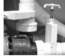
Sperrschieber und Pumpenverschraubung
