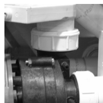
Sperrschieber und Pumpenverschraubung
