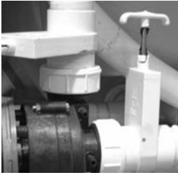
Sperrschieber und Pumpenverschraubung
